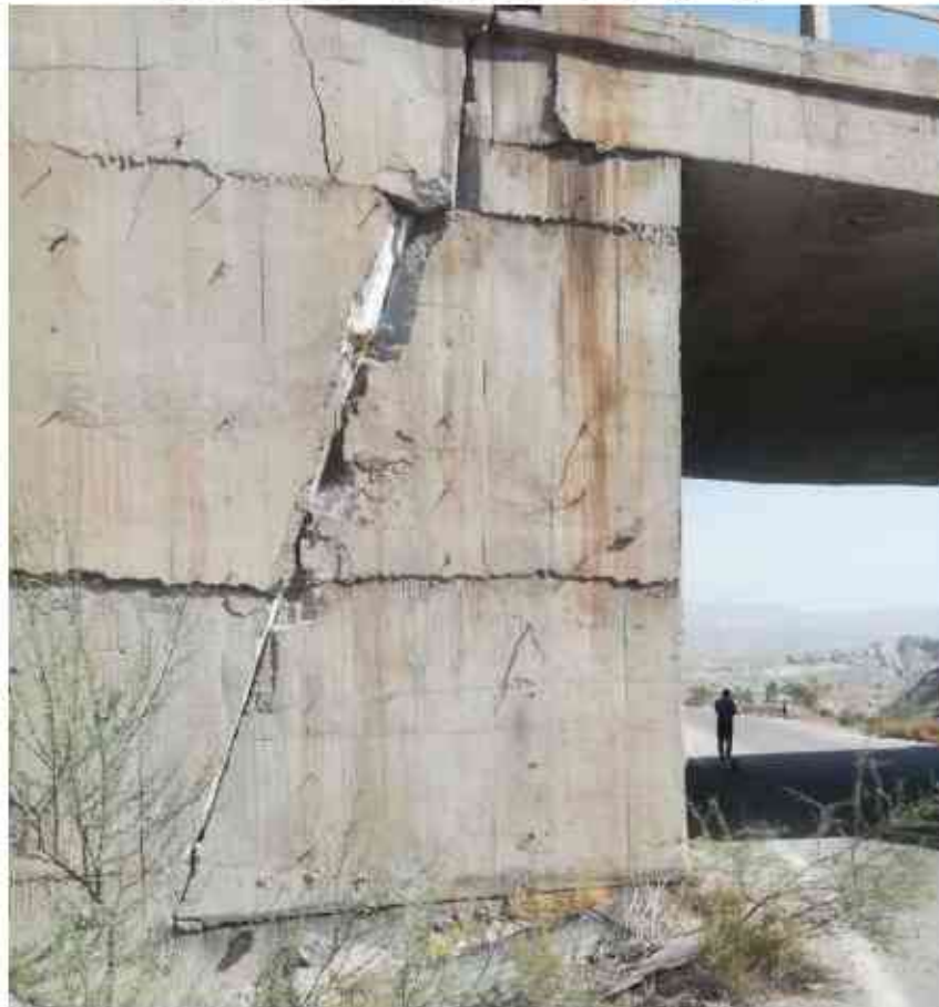
تصویر ۹۹ ترک قائم ایجاد شده در پل نزدیک به روستای گیشان
