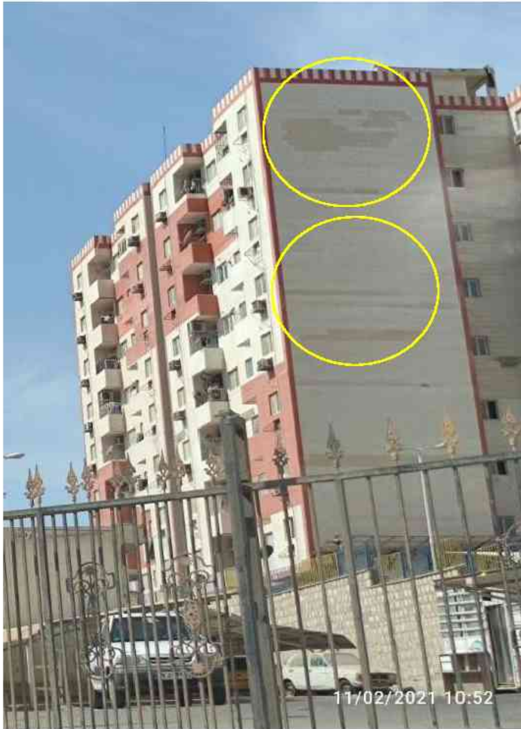
تصویر ۶۴ ریزش نمای سنگ و سرامیک ساختمان در مجتمع‌های مسکونی شهر بندرعباس
