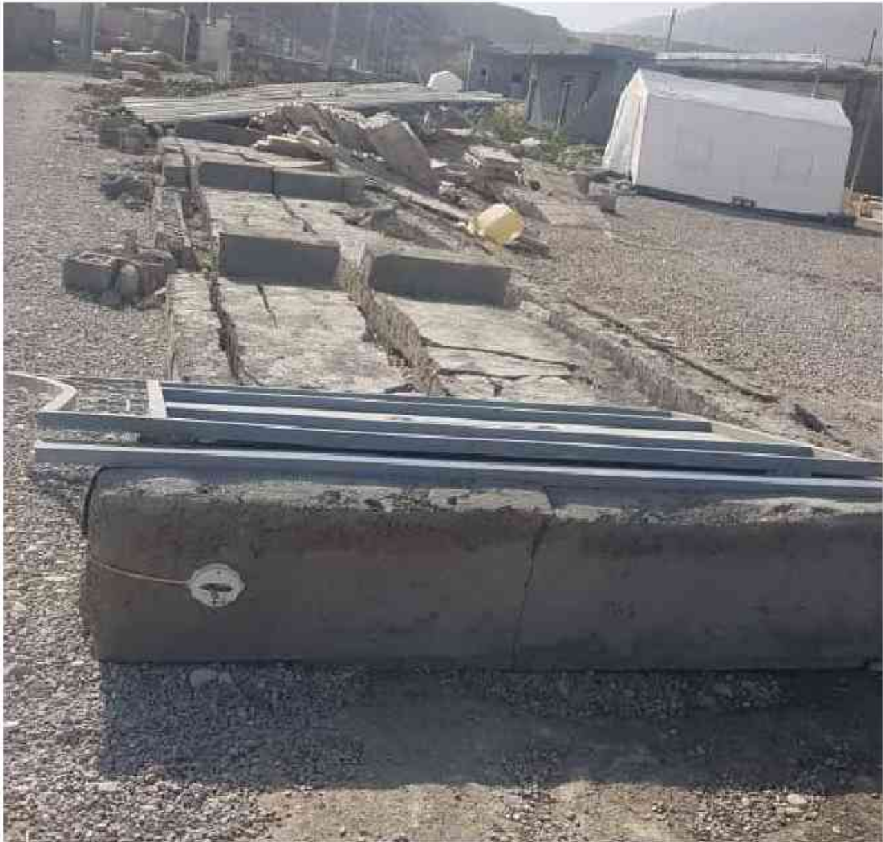
تصویر ۷۰ ریزش دیوارهای بلوک سیمانی در روستای گیشان غربی
