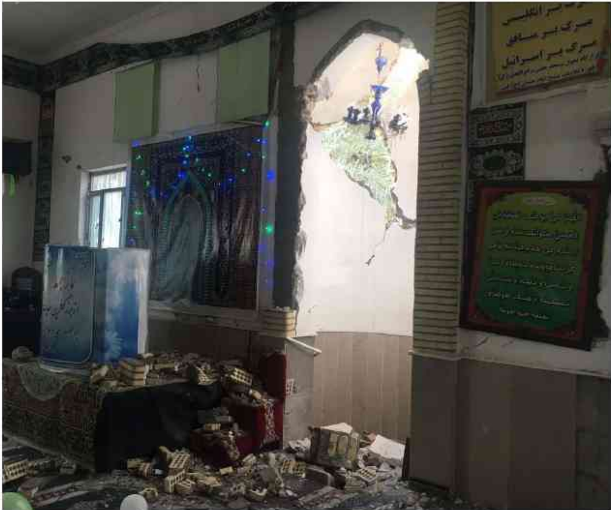
تصویر ۸۷ جذب نیروی جانی توسط مجراب و ایجاد ترک‌های یرشی در آن
