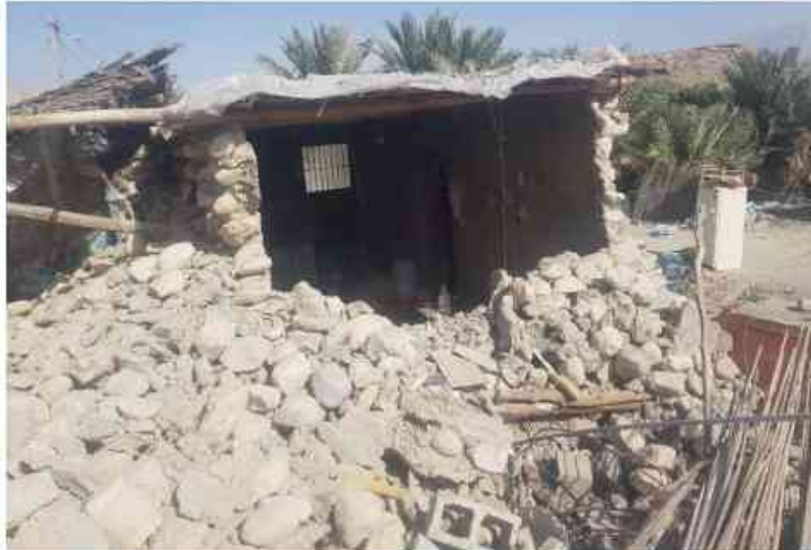
تصویر ۲۸ ریزش ساختمان‌های با دیوارهای سنگی و سقف چوبی در روستای مزرا
