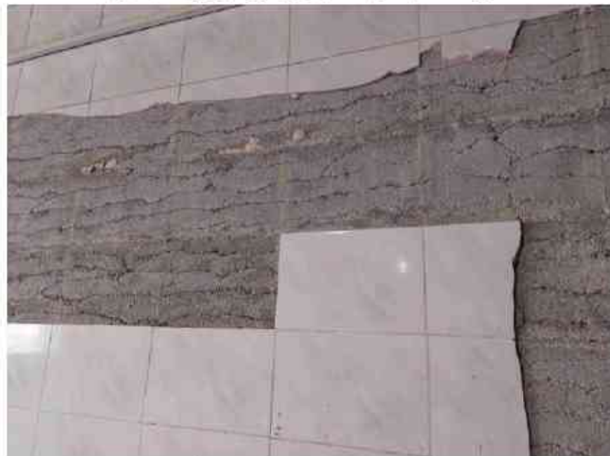
تصویر ۸۲ عدم اجرای صحیح زیرسازی سرامیک دیواری (بخش قین)
