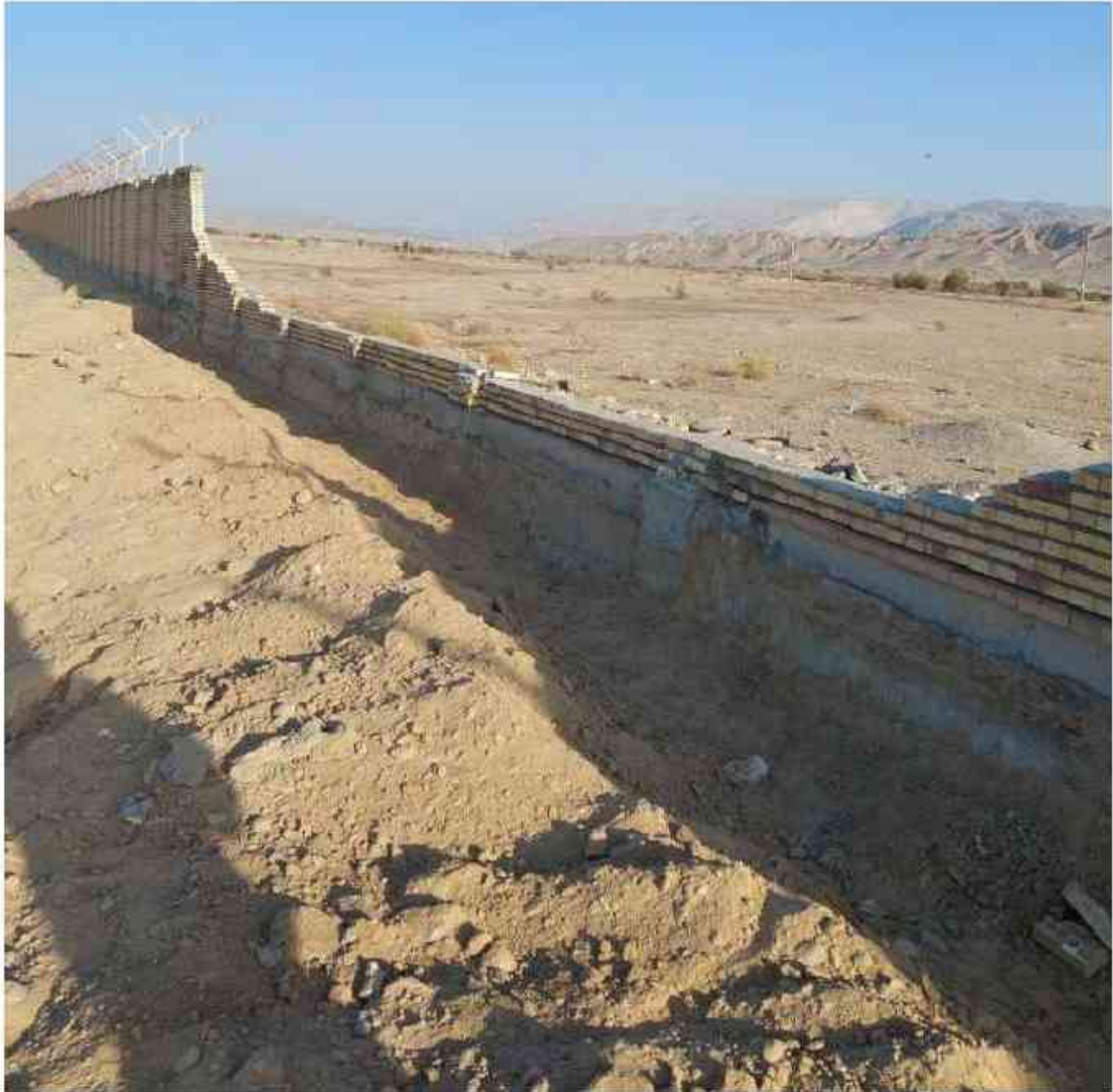
تصویر ۲۱ اجرای یکپارچه دیوار، بدون در نظر گرفتن کلاف‌های قائم و درز بین دیوارها در فواصل مناسب (بخش فین)
