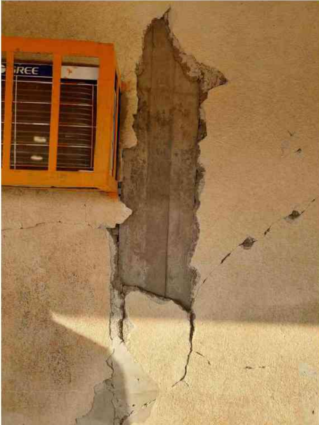
تصویر ۴۲ اجرای غیر اصولی دیوار میان قاب و جدا شدن و آسیب دیدن دیوار در اثر حرکت قاب (بخش فین)
