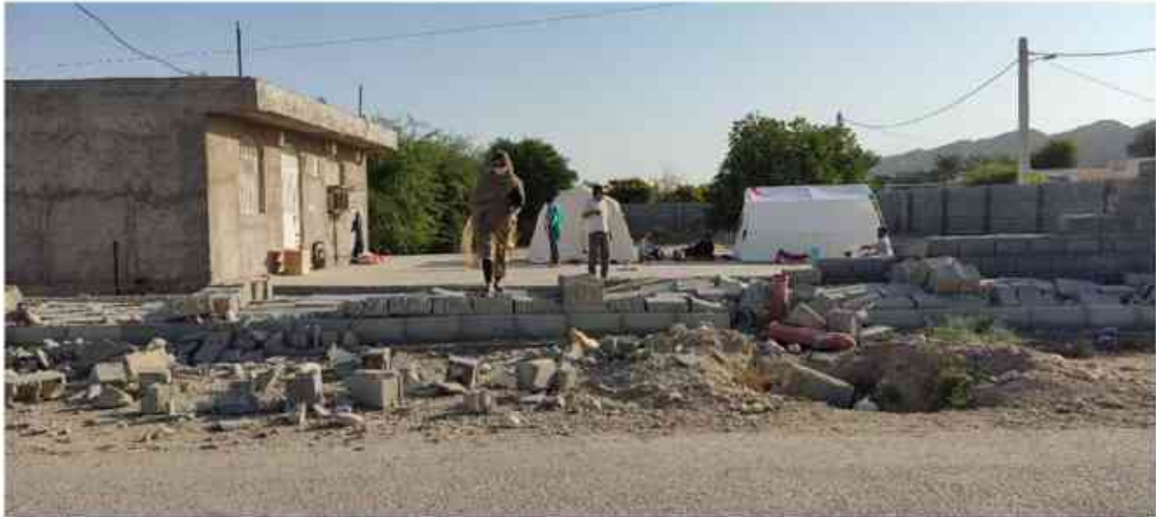
تصویر ۷۴ ریزش دیوار پیرامونی به دلیل عدم استفاده از ملات مناسب و عدم اجرای شناژ و زیرسازی در روستای سرزه.
