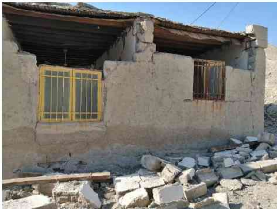
تصویر ۲۹ ریزش دیوارهای بلوکی با سقف چوبی در روستای گیشان غربی
