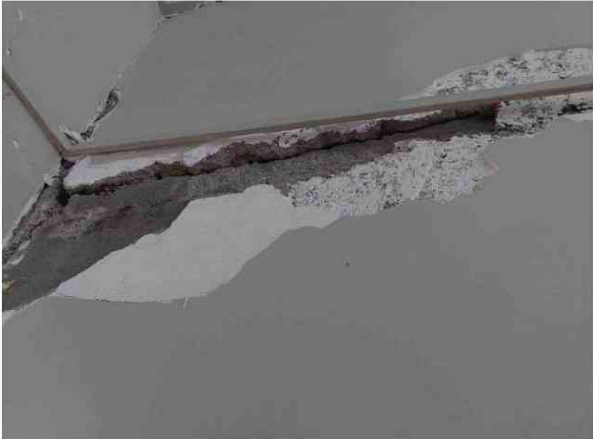
تصویر ۴۲ اجرای غیر اصولی دیوار غیر سازه‌ای بر روی تیر سازه‌ای و جدا شدن دیوار در هنگام زلزله (بخش فین)
