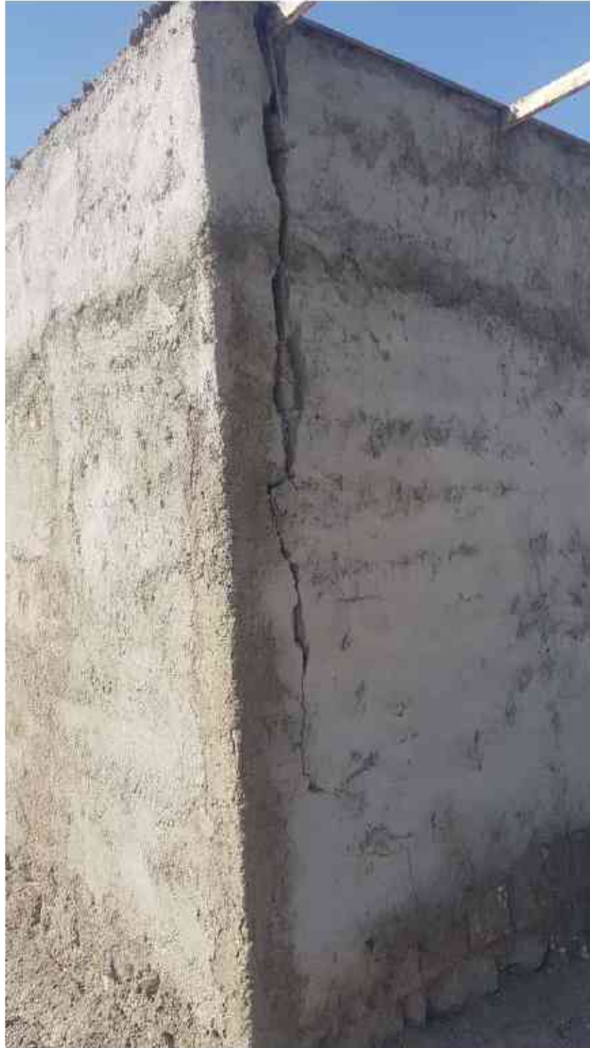
تصویر ۱۸. ترک ایجاد شده در دیوار بلوک سیمانی ساختمان بدون کلاف روستای ذرتو
