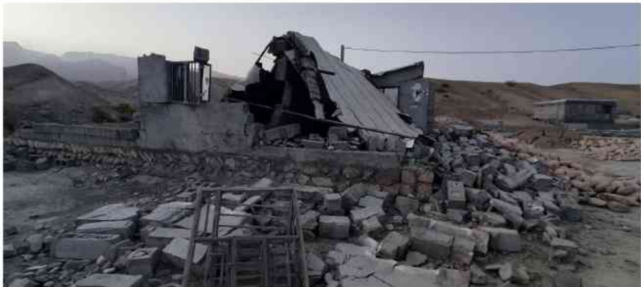
تصویر ۲۴ ریزش سقف (سپری و سرامیک) و دیوار بلوکی به دلیل عدم اجرای کلاف در روستای گیشان
