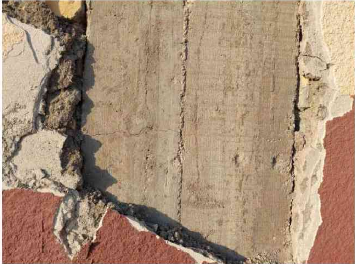
تصویر ۴۵ وجود ترک در پای برخی از ستون‌ها و کاهش ظرفیت باربری ستون (بخش فین)
