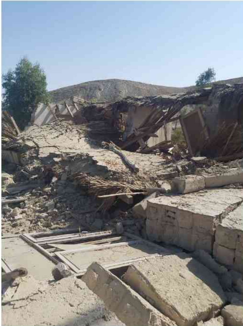
تصویر ۳۰ ریزش سقف اجرا شده با شاخه‌های نخل و گل در روستای مزرا
