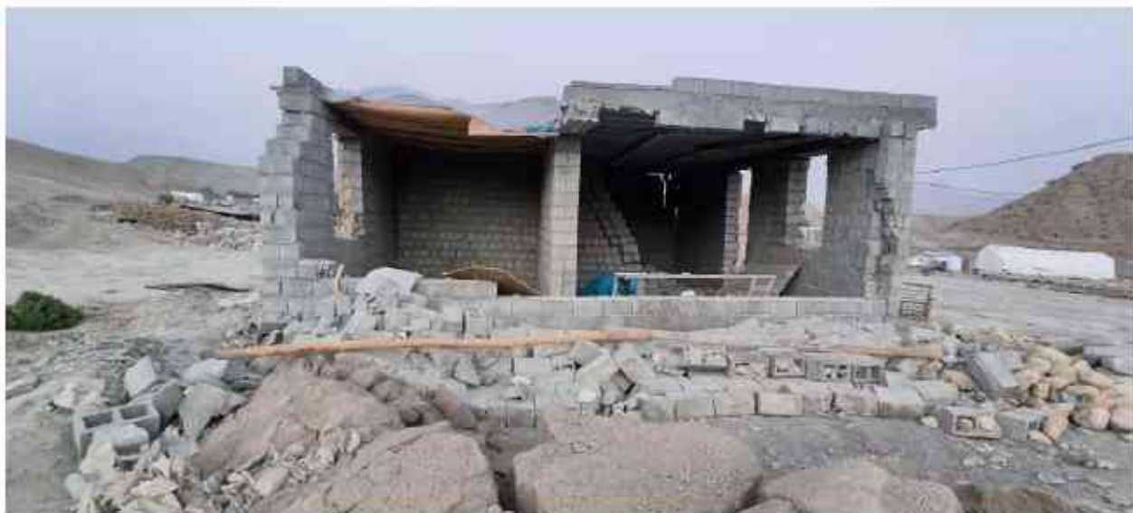
تصویر ۲۰ ریزش دیوار باربر ساختمان و بخشی از سقف به دلیل عدم اجرای کلاف و استفاده از ملات مناسب در گیشان غربی
