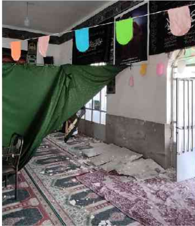
تصویر ۸۱ عدم اسکوپ سنگهای پیرامون دیوار در مسجد قین
