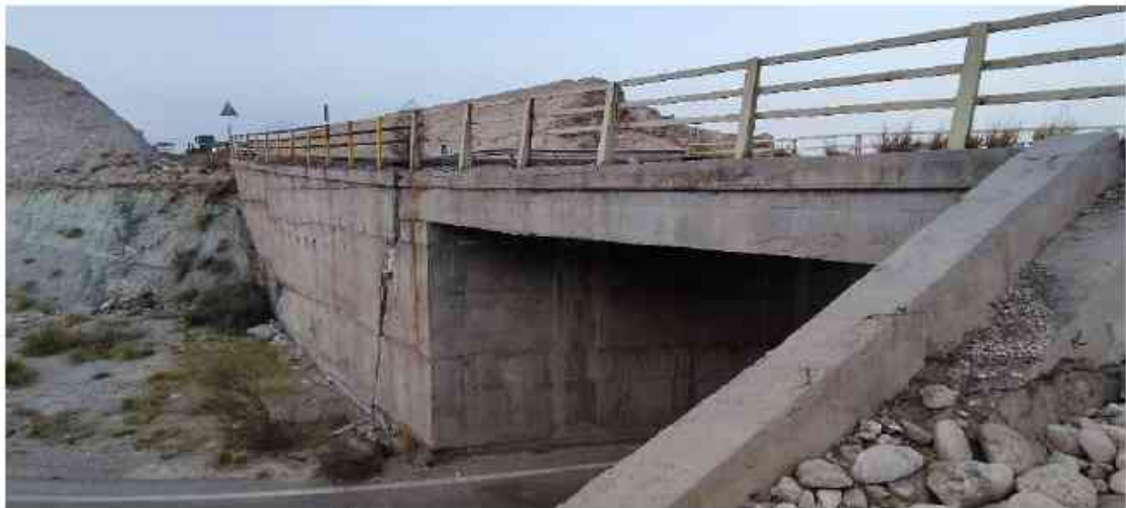
تصویر ۹۷ جابجایی و ایجاد ترک در دیواره پل در رسیده به روستای گیشان غربی
