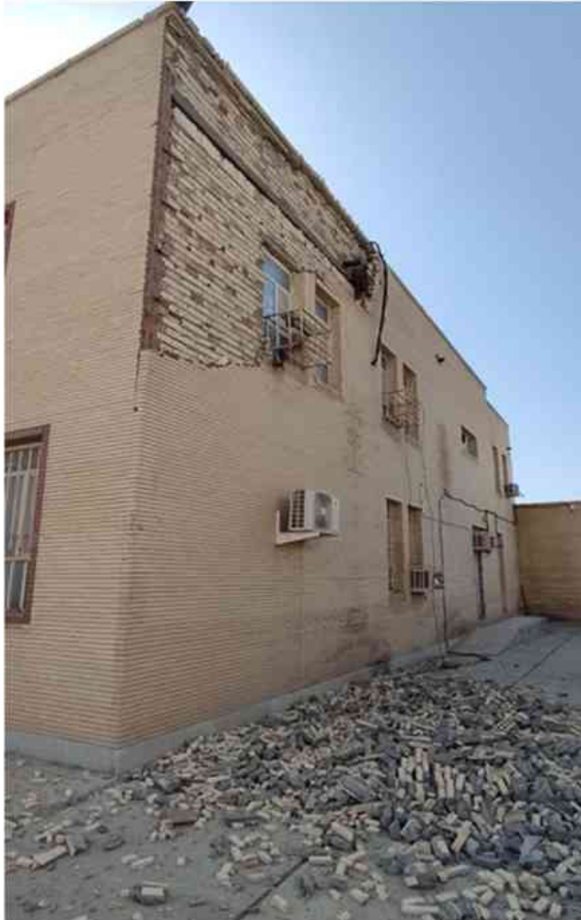
تصویر ۵۸ ریزش نمای پلاک آجری به دلیل عدم اتصال مناسب نما به سازه
