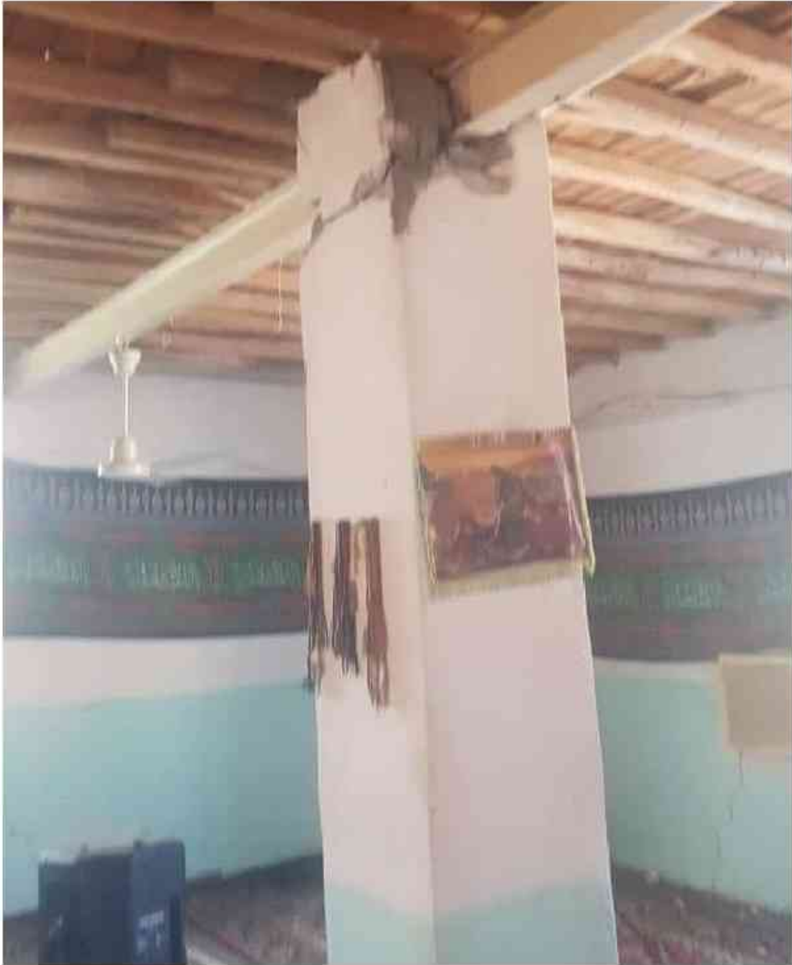
تصویر ۸۸ ترک‌های برشی ستون در مسجد روستای درتو
