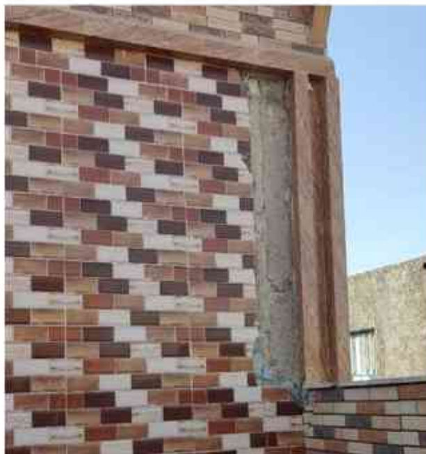
تصویر ۵۷ ریزش نمای سرامیک به دلیل عدم اتصال مناسب تما به سازه در روستای سرزّه
