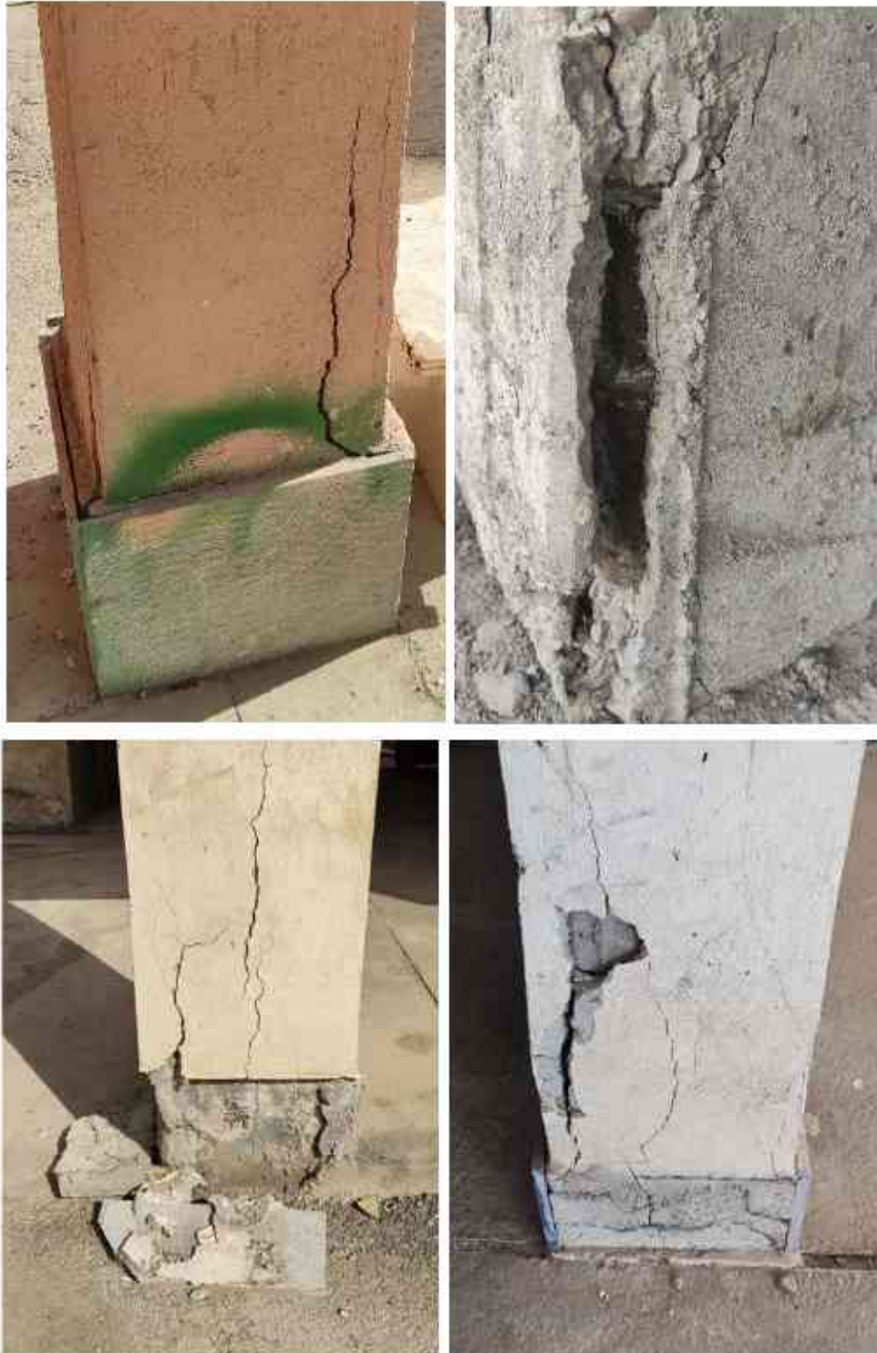
تصویر ۵۶ خوردگی ستون‌های بتنی و فرودآسیب سازه به دلیل بالا بودن سطح آب زیرزمینی در بندرعباس
