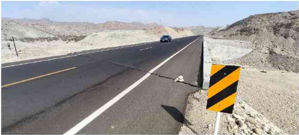
تصویر ۹۶ جابجایی پل در محل درز انقطاع در ۲ کیلومتر ۳ جاده سیاهر
