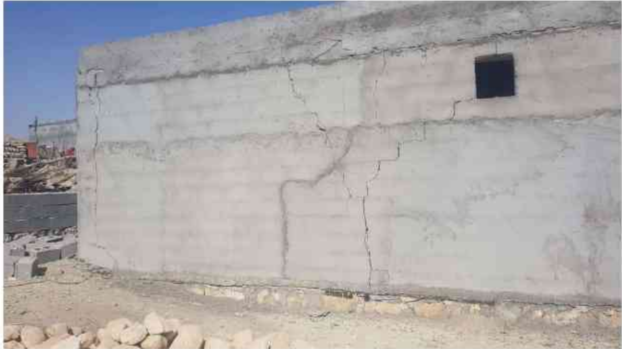
تصویر ۱۶ ترک‌های قطری و قائم در دیوار فاقد کلاف در روستای مژرا
