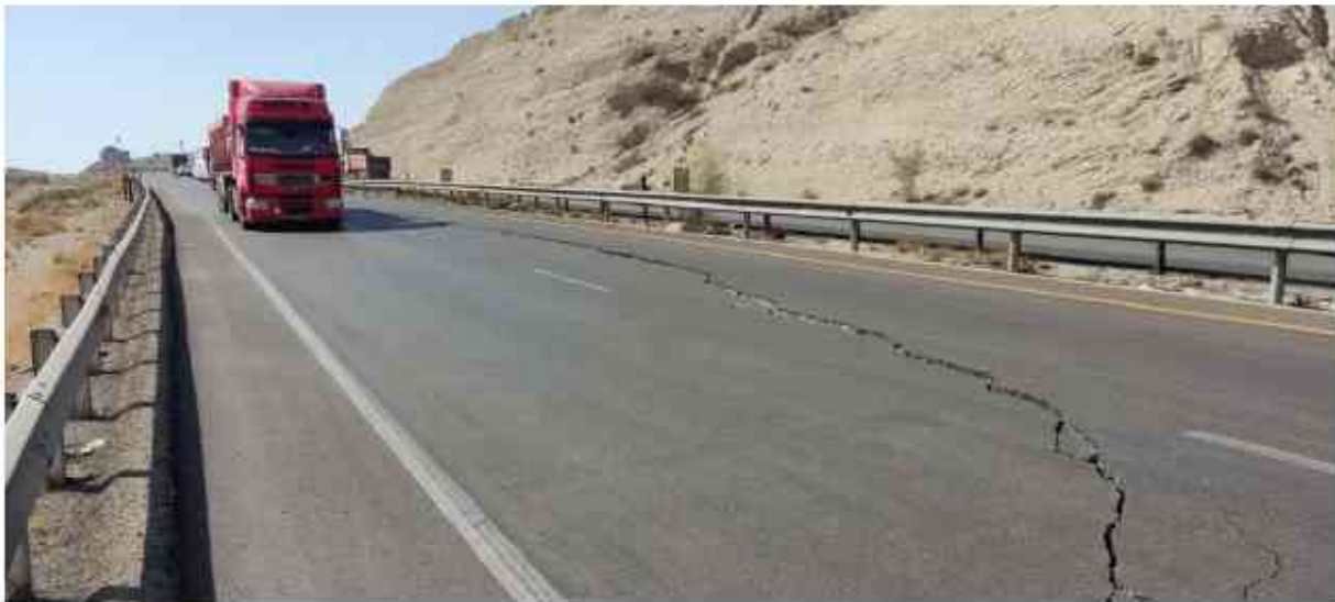
تصویر ۹۰ ترک خوردگی طولی ناشی از گسیختگی برشی شیروانی خاکی در مجاورت تونل شهید میرزایی
