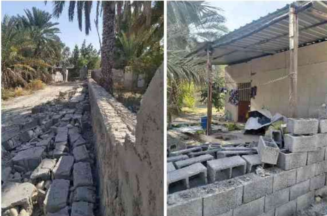
تصویر ۶۸ ریزش دیوار پیرامونی اجرا شده با بلوک سیمانی با ملات و بدون ملات (خشکه چینی) در روستای مزرا
