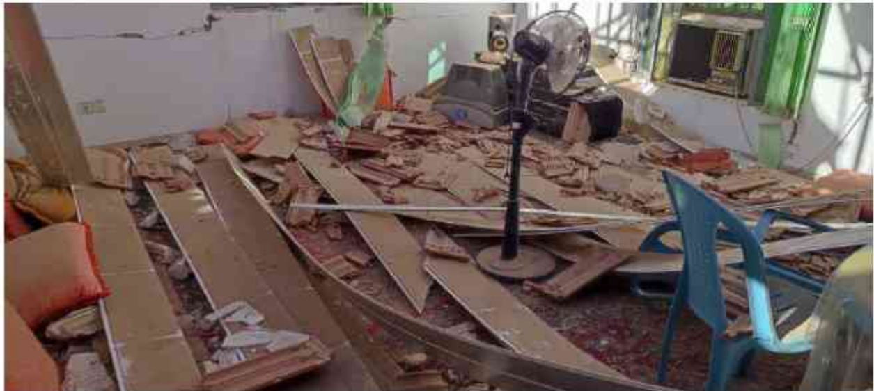
تصویر ۳۷ ریزش سقف سفالی و به طبع آن سقف گاذب در روستای ذرتو
