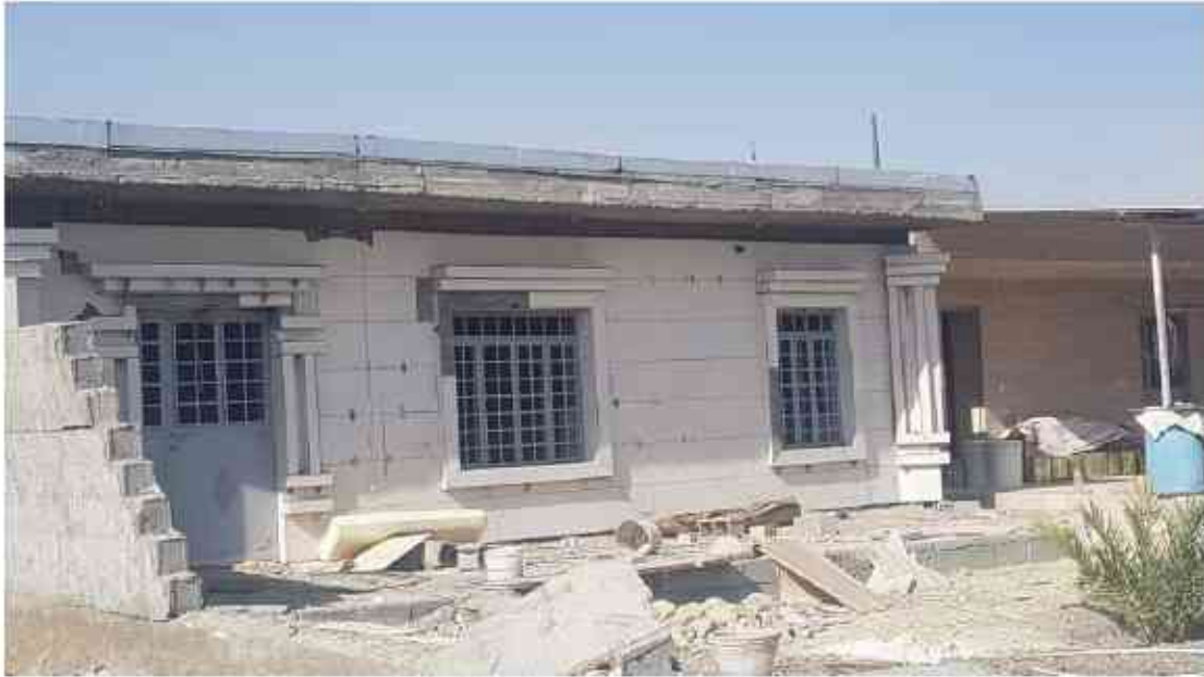
تصویر ۶۷ ریزش نما و دیوارهای محیطی در ساختمان کلاف‌دار در روستای گیشان غربی
