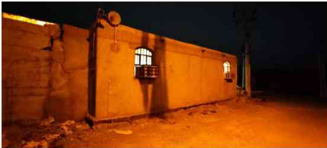
تصویر ۸۵ عدم ایجاد ترک و خسارت در مسجد گیشان غربی به دلیل اجرای صحیح کلاف افقی و عمودی
