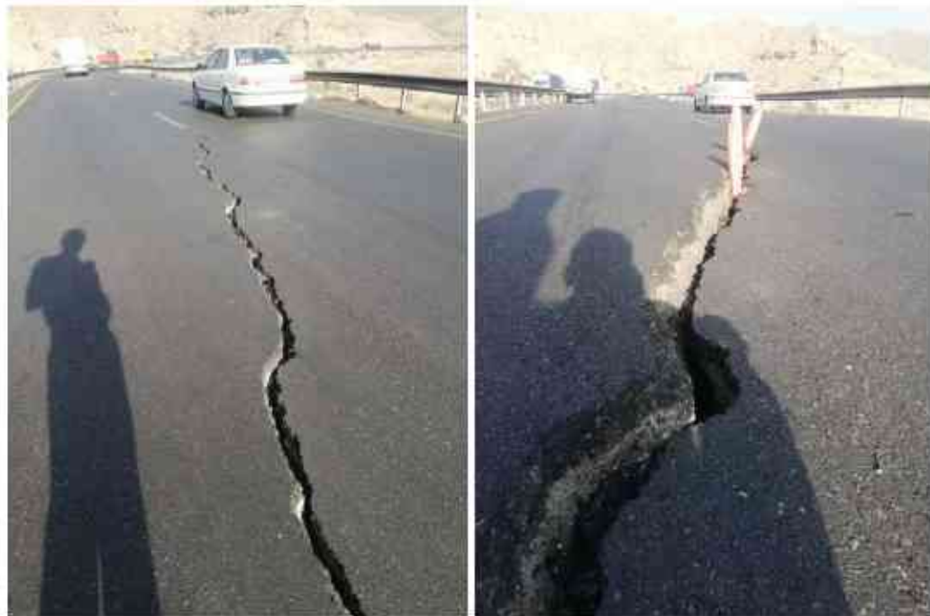
تصویر ۹۳ ایجاد شکاف در آسفالت محور بندرعباس - سیرجان
