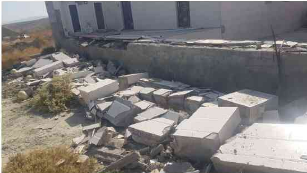
تصویر ۶۹ ریزش دیوارهای بلوکی دیوار حیاطی در روستای گیشان غربی
