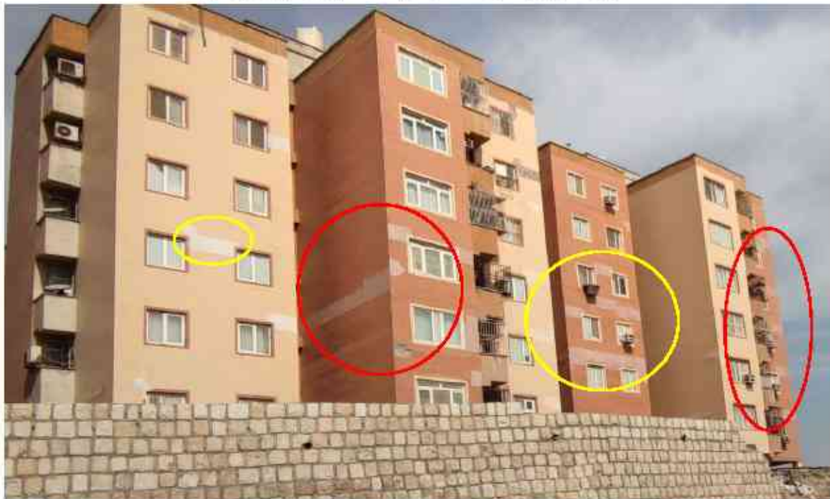
تصویر ۶۰ ریزش نمای سنگ و سرامیک از ارتفاع به دلیل اجرا و اسکوپ نامناسب در بندرعباس
