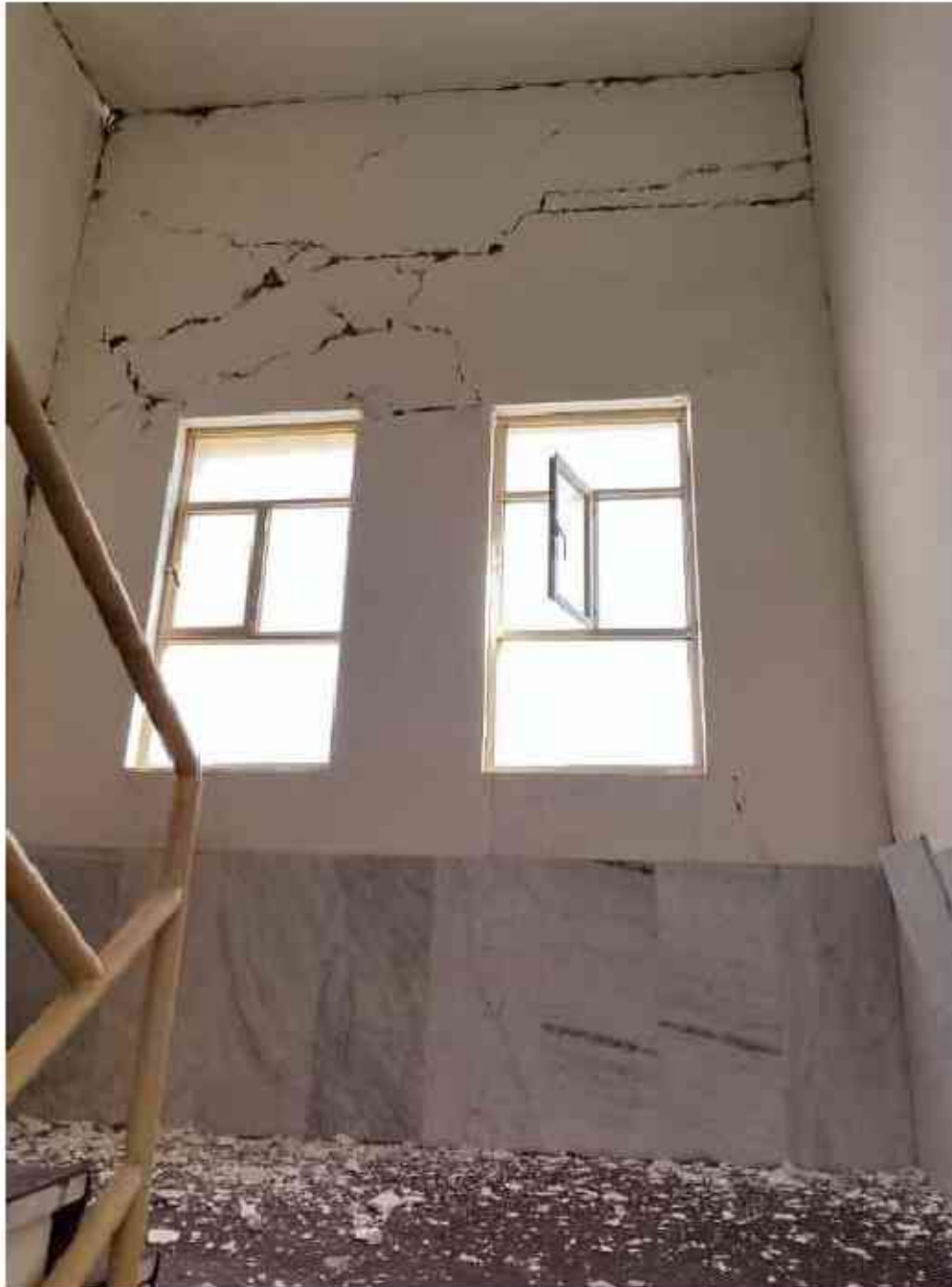
تصویر ۷۶ ترک‌های افقی دیوار و ریزش خرپشته در محل شهرداری قین
