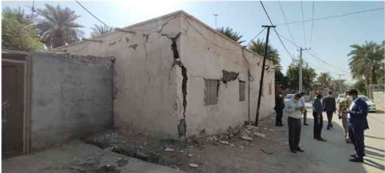
تصویر ۲۱ ترک دیوار خارجی ساختمان خشت و گلی در قین (یک لایه دیوار با فلات سیحان در پشت اجرا شده است)
