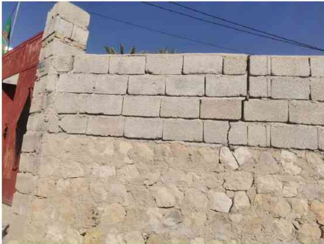
تصویر ۷۵ ایجاد ترک قائم در دیوار پیرامونی (روستای قطب آباد)
