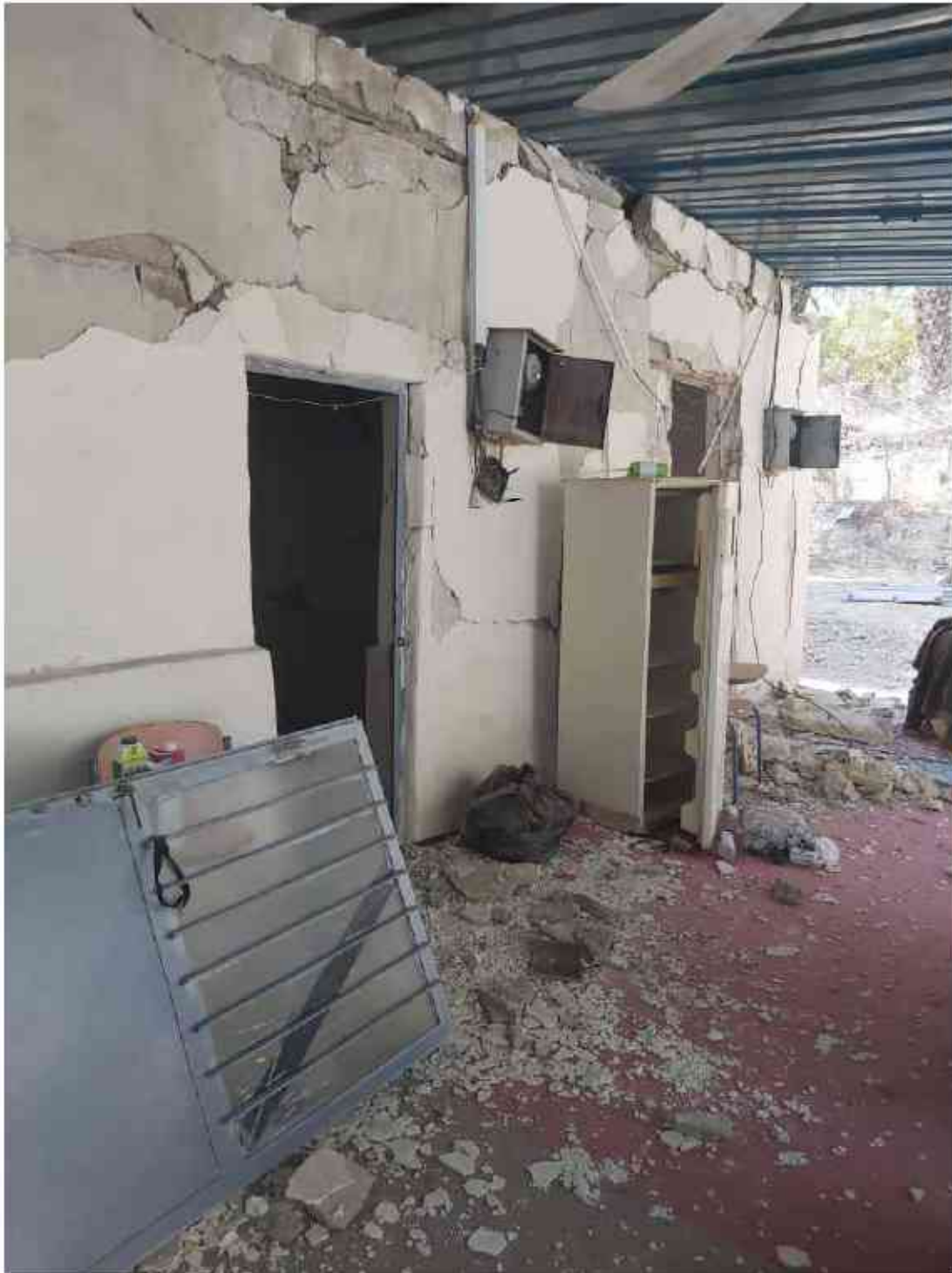
تصویر ۲۵ ترک‌های افقی دیوار بلوک سیمانی در روستای مژرا
