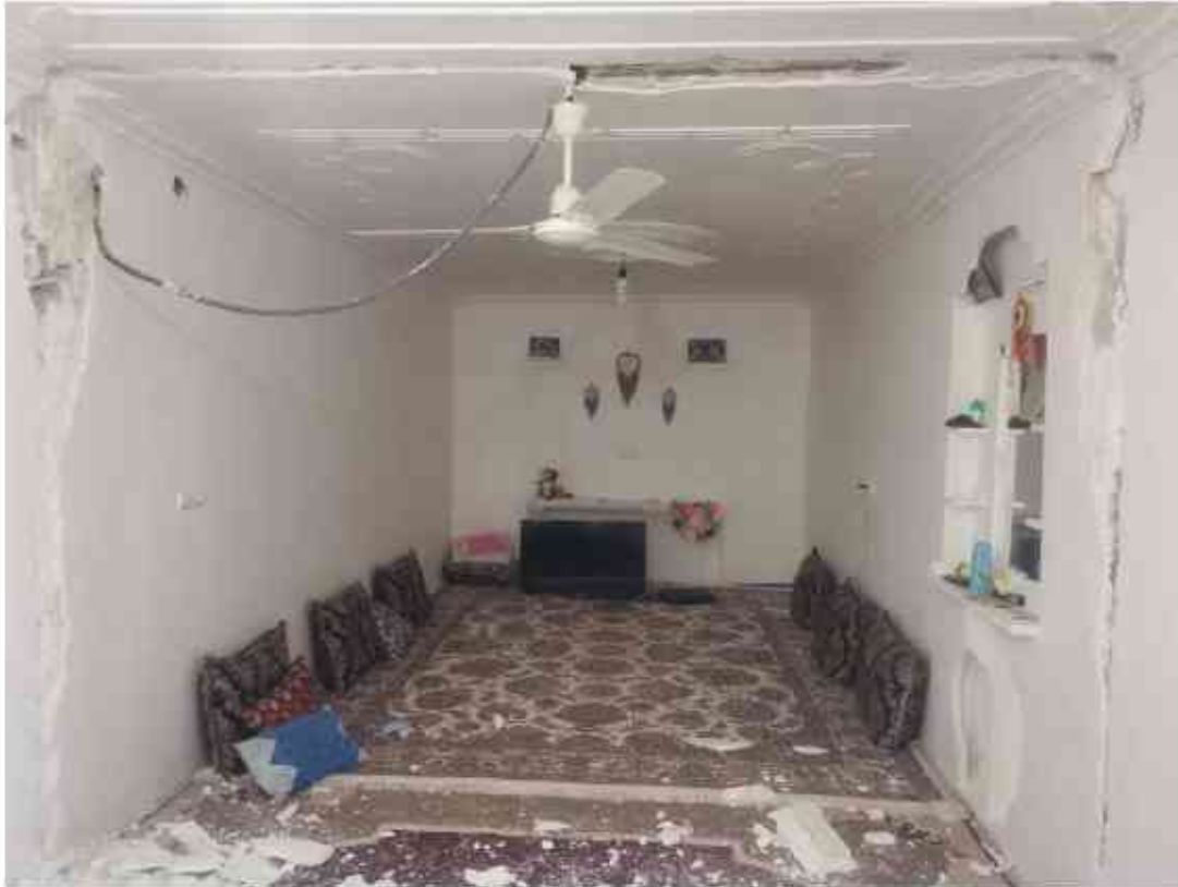
تصویر ۱۹ ایجاد ترک قائم در دیوارهای بلوک سیمانی روستای قطب آباد.
