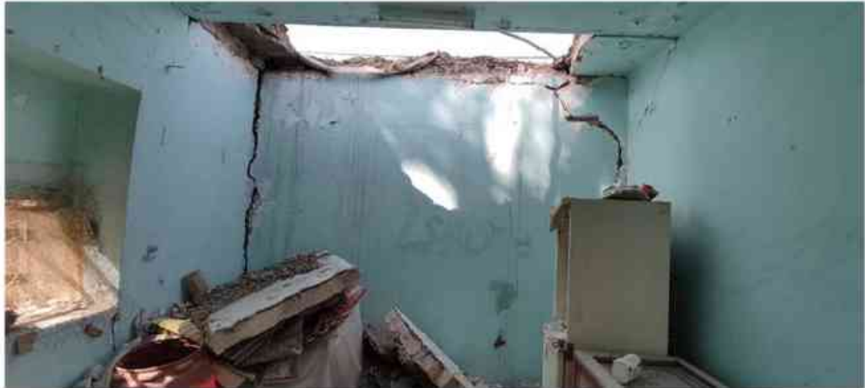
تصویر ۲۳ ریزش بخشی از سقف طاق ضربی به دلیل حرکت دیوار و عدم پیوستگی سقف با میلگردهای مهار
