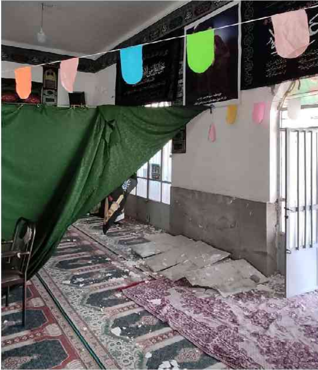
تصویر ۸۹ ریزش سنگ نمای داخلی به دلیل عدم رعایت اسکوپ مناسب در مسجد قین
