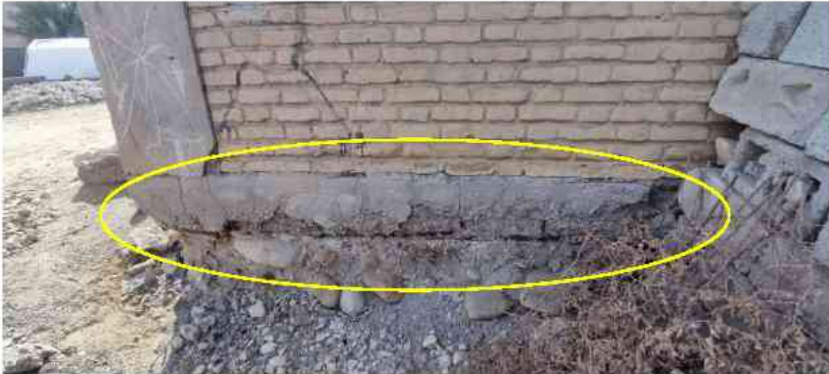
تصویر ۴۹ خوردگی کلاف و پای ستون سازه بتنی منبع آب در روستای سرره
