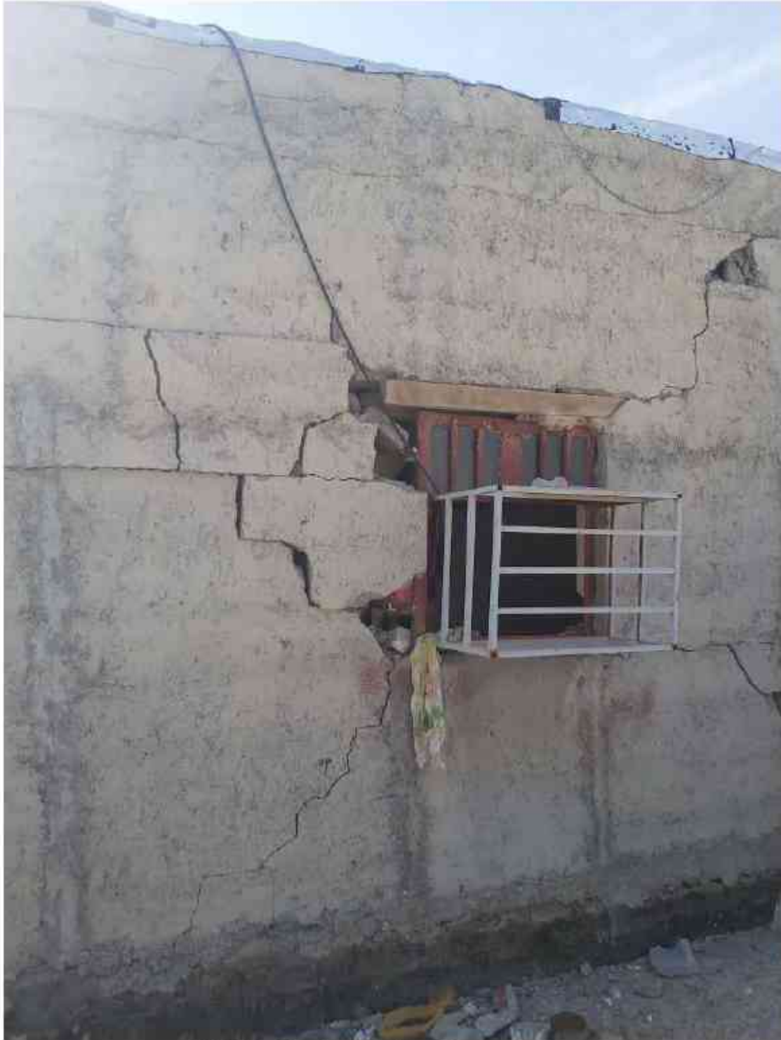
تصویر ۱۵ ترک‌های قطری دیوار در ساختمان بلوکی فاقد کلاف
