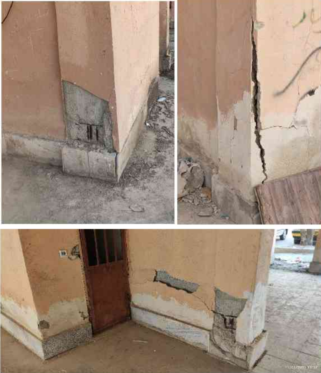
تصویر ۵۵ خوردگی ستون‌های بتنی و فونداسیون سازه به دلیل بالا بودن سطح آب زیرزمینی در بندرعباس
