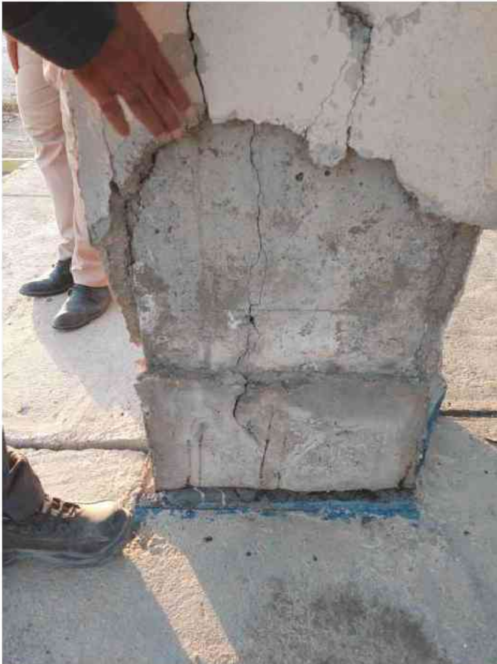
تصویر ۴۷ وجود ترک در پای درخی از ستون‌ها و کاهش ظرفیت باربری ستون (بخش فین)
