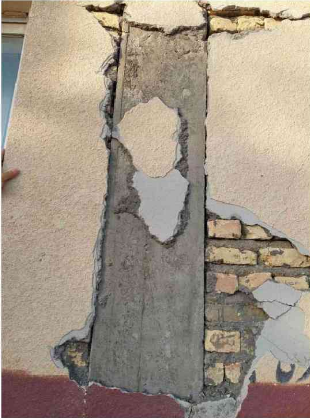
تصویر ۴۴ اجرای غیراصولی دیوار میان قاب و جدا شدن و آسیب دیدن دیوار در اثر حرکت قاب (بخش فین)
