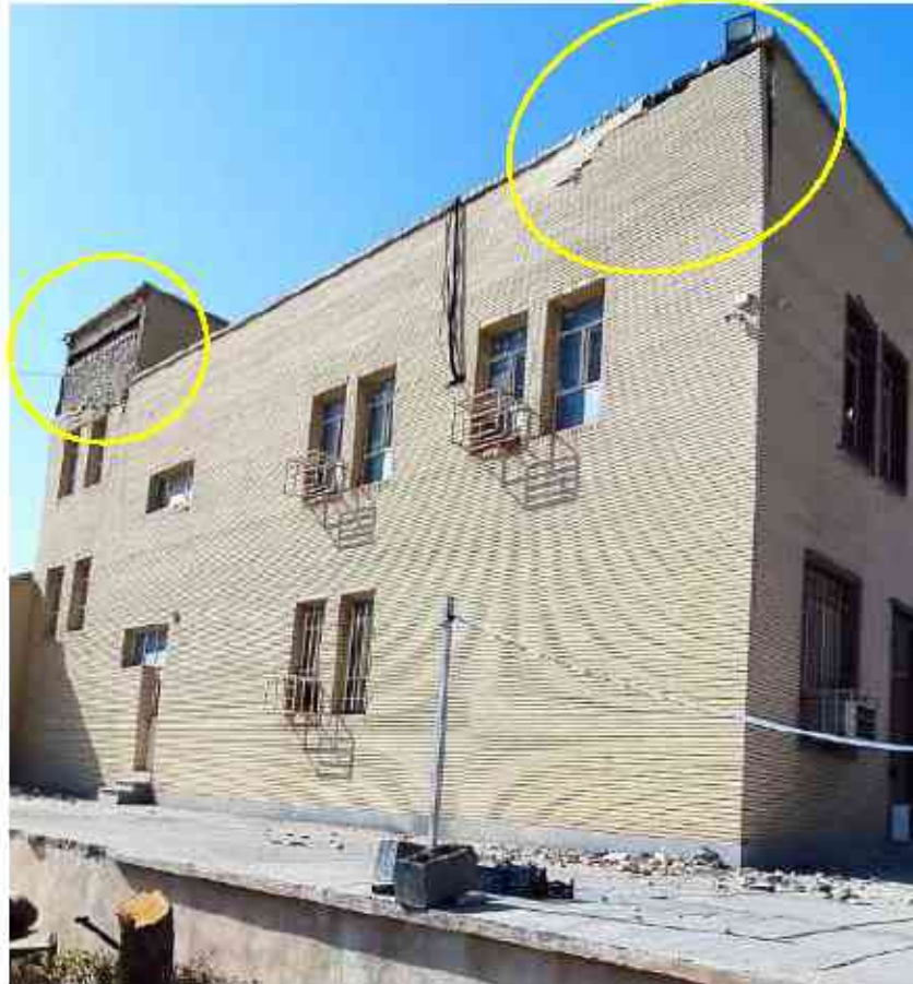
تصویر ۶۵ ریزش بلاک آجری خرپشته و عدم اتصال مناسب نما به ساختمان در شهرداری فین
