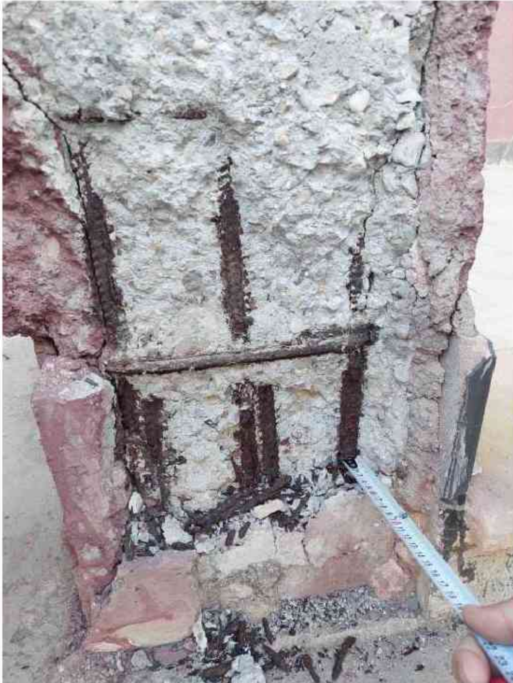
تصویر ۵۲ پدیده خوردگی آرماتور در ستون و تخریب بتن ناحیه پوشش بتن در هنگام زلزله (بخش قبین)
