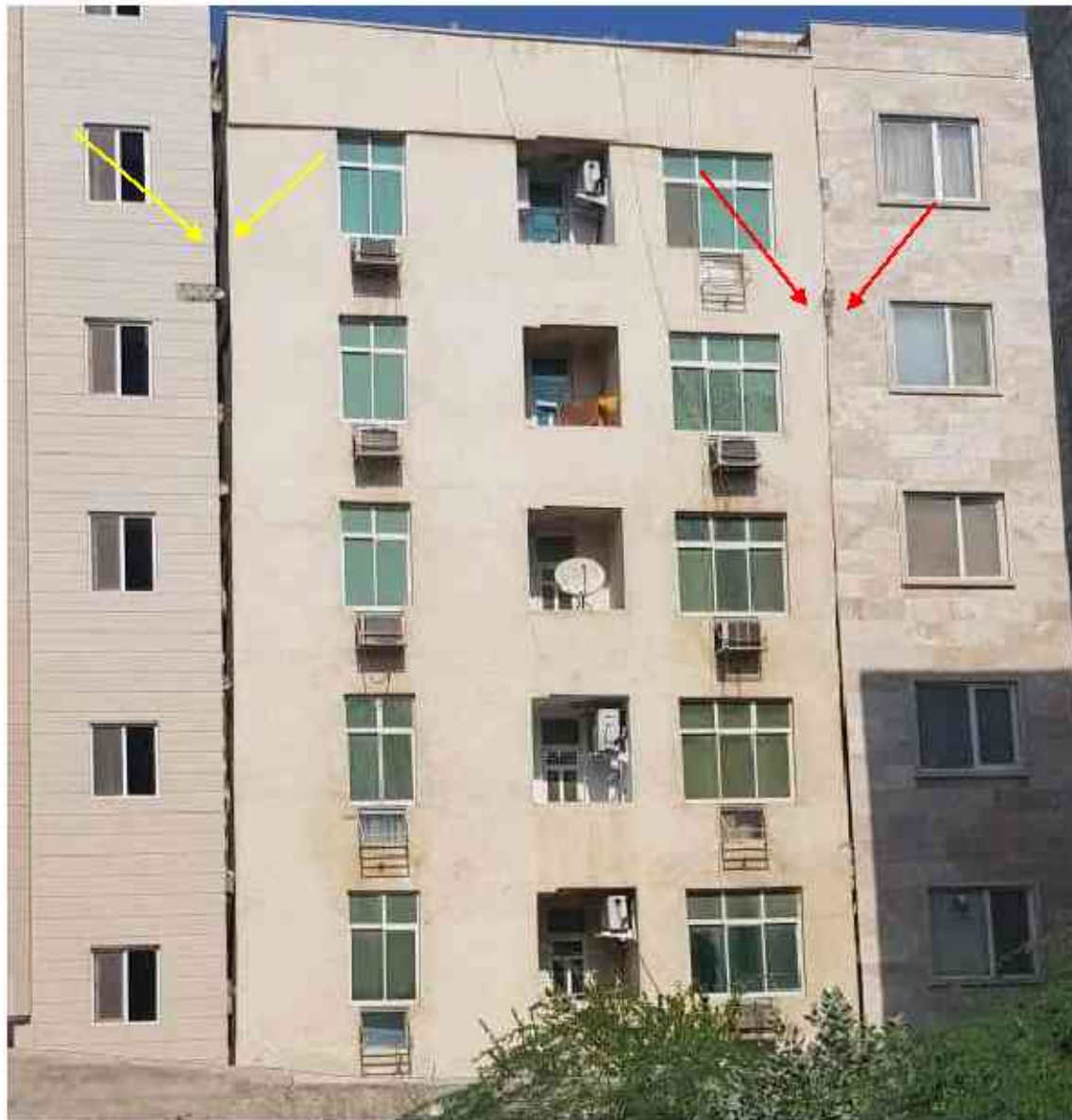
تصویر ۱۲ نشست و چرخش ساختمان به راست و جلو در الهیه جنوبی بندرعباس
