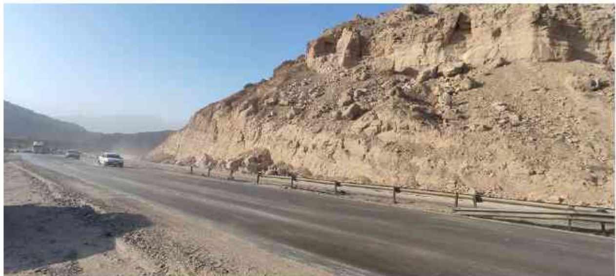
تصویر ۱-۱ ناپایداری قطعات سنگی شیب مجاور جاده در نزدیکی تونل شهید میرزایی
