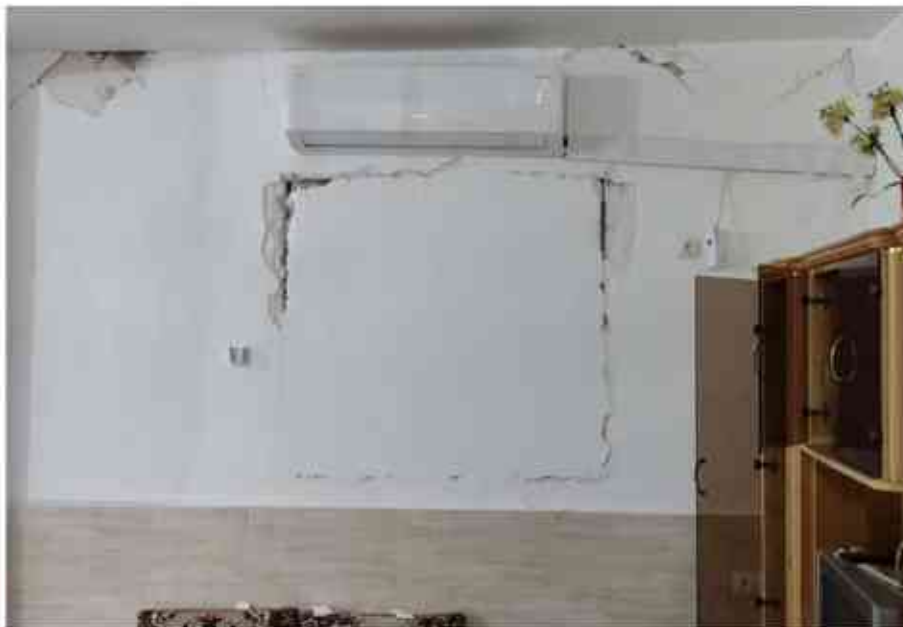
تصویر ۸۴ ایجاد ترک در دورتادور محل باز شو پنجره پوشانده شده با مصالح بتابی
