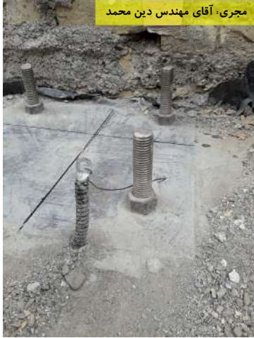
سیم خارج شده از بتن، دارای کابلشو
